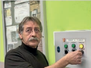
Denis Ferri, adjoint aux travaux, explique l'importante rénovation énergétique qui vient d'être réalisée à la salle polyvalente.
